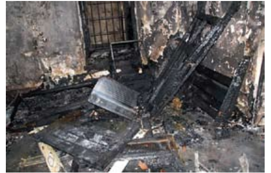
Et af kælderrummene i efter branden i C&MA's bygning i Jerusalem.
